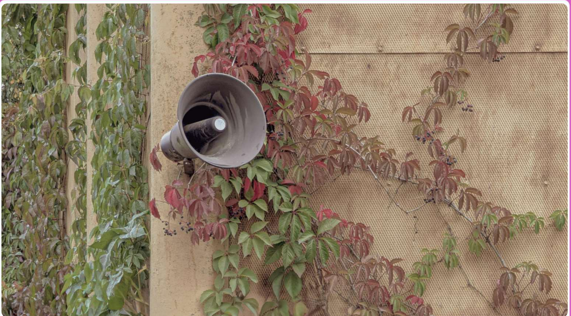
Figura 1. Una bocina instalada en una pared parcialmente cubierta por enredaderas, sugiriendo una interacción entre la propagación del sonido y la presencia de vegetación.
